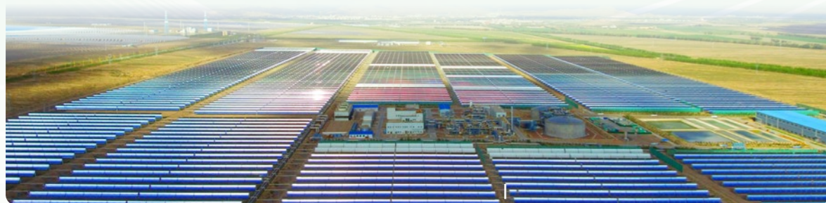
中广核青海德令哈 50 兆瓦光热发电示范项目
