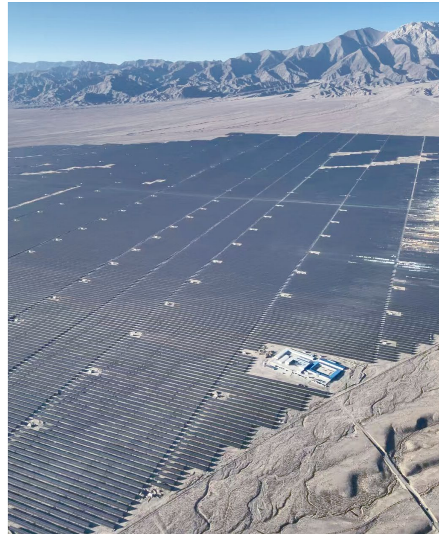
中广核青海德令哈 100 万千瓦光热储一体化项目配置的 80 万千瓦光伏发电项目
