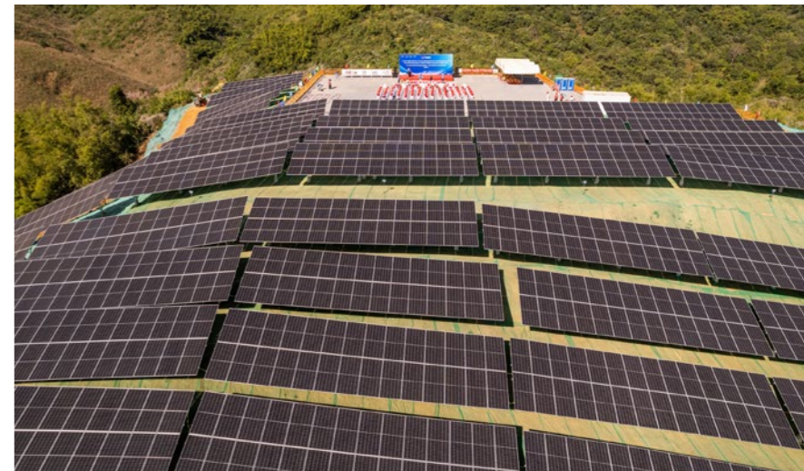
老挝首个大规模光伏项目——中广核老挝北部互联互通清洁能源基地一期 100 万千瓦光伏项目正式开工建设
